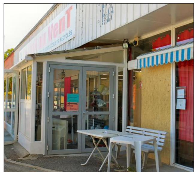
Sur la façade du Nez au Vent, une planche remplace maintenant la vitre, brisée par les voleurs, qui ont dérobé la caisse.
